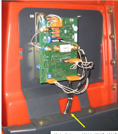
Kabelbäume W11, W12, W15
